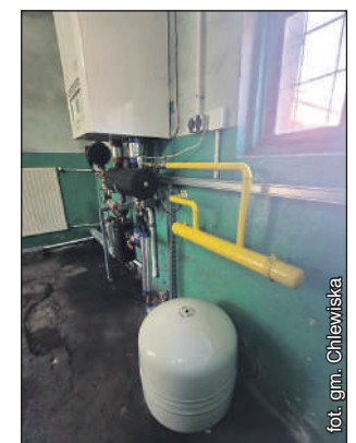
Stary piec węglowy został zastąpiony nowoczesnym kotłem gazowym
