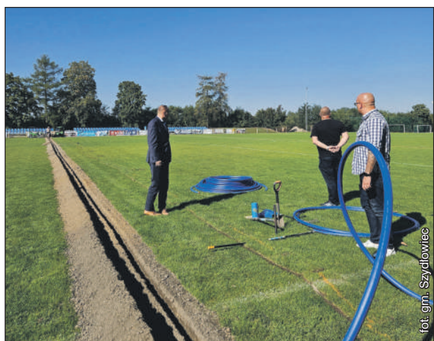
Instalacja nawadniająca na stadionie MKS Szydłowianki Szydłowiec
