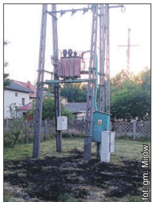
2 lipca 2025 roku, w godzinach popołudniowych, na ujęciu wody w Mirówku doszło do awarii
