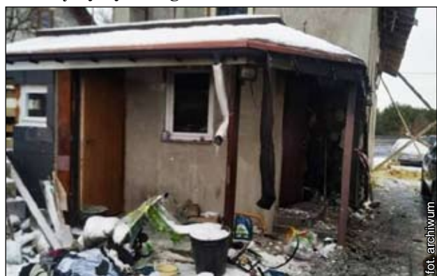
Zrujnowany, zniszczony wybuchem gazu dom
