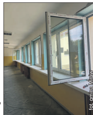
Inwestycja modernizacji kotłowni i instalacji co w obiektach użyteczności publicznej na terenie Gminy Mirów pozwoli podnieść efektywność energetyczną budynków
