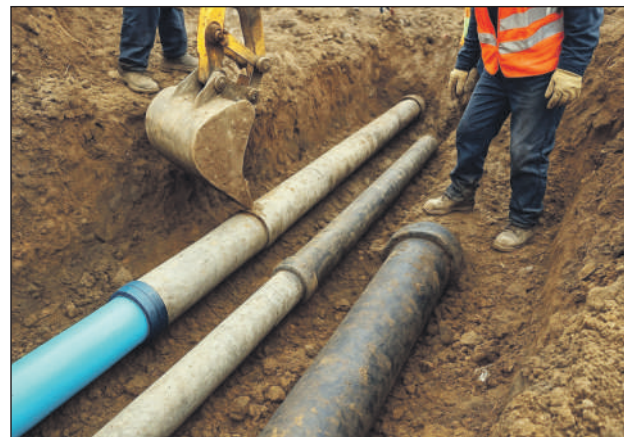
Mieszkańcy osiedla Północ w Szydłowcu zwrócili się z pytaniem o stan sieci wodociągowo-kanalizacyjnej na tzw. Pradze
