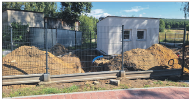
Przepompownia w Zbijowie Dużym
