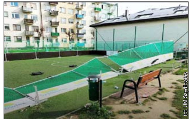
Tak wyglądało uszkodzone ogrodzenie
