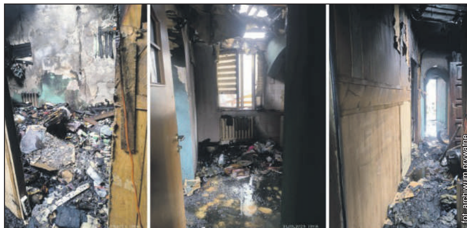
Tak wyglądało wnętrze spalonego domu
