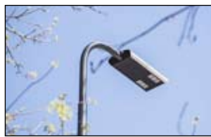
Nowoczesne oświetlenie uliczne LED
