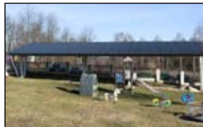
Instalacja fotowoltaiczna przy PSP w Zbijowie Małym
