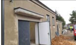
Modernizowana stacja hydroforowa w Mirówku
