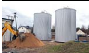
Modernizowana stacja hydroforowa w Mirówku
