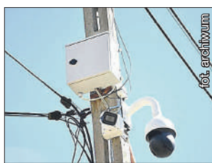
Gdzie jeszcze powinny zostać zamontowane kamery monitoringu
